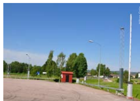
Testplats Djurås med inriktning på tjänster och utrustning kopplat till säker parkering har bomsystem och mastar för kameraövervakning.
