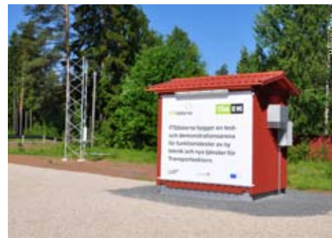
Testplats Amsberg är inriktad på trafikmätning-utrustning, vädersensorer, trafikkameror etc.
